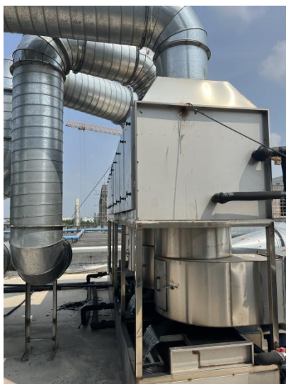
FQ-02 排气筒配备的水喷淋+干湿分离装置（东）
