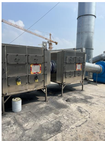
FQ-02 排气筒配备的二级活性炭吸附装置（西）
