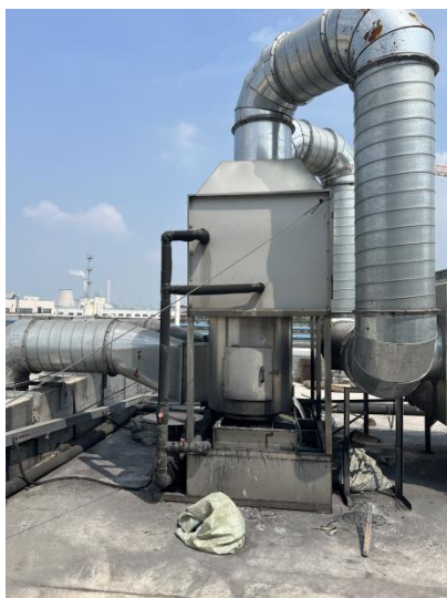
FQ-02 排气筒配备的水喷淋+干湿分离装置（西）
