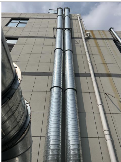
FQ-01 排气筒南北两路管道
