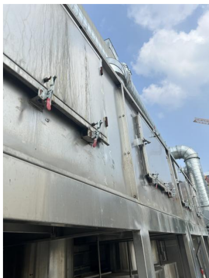
FQ-01 排气筒配备的水喷淋+干湿分离装置
