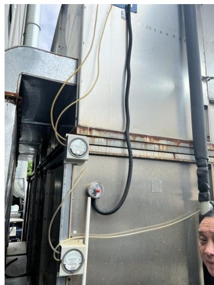
FQ-01 排气筒配备二级活性炭吸附装置
