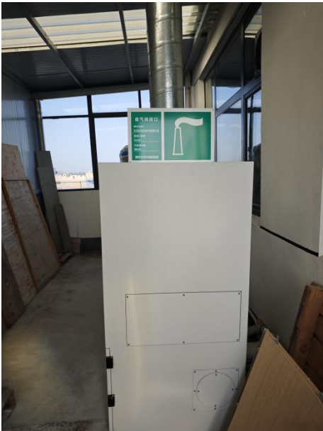
1#排气筒及环保标识牌
