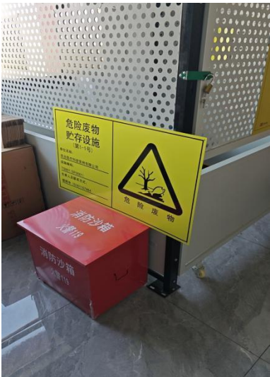
危废仓库贮存设施标牌及配备的黄沙箱
